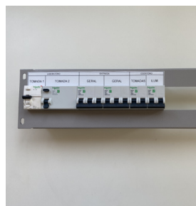
Sem tampa disjuntor furo DIN
